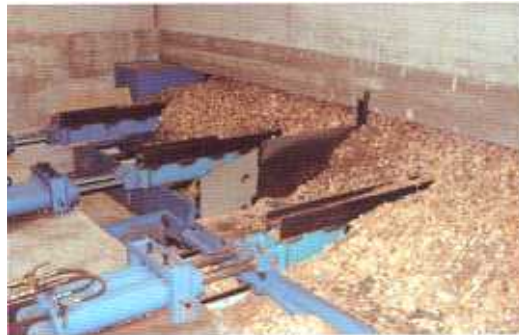
(a sinistra) IMPIANTO DI TELERISCALDAMENTO DI MORGEX
